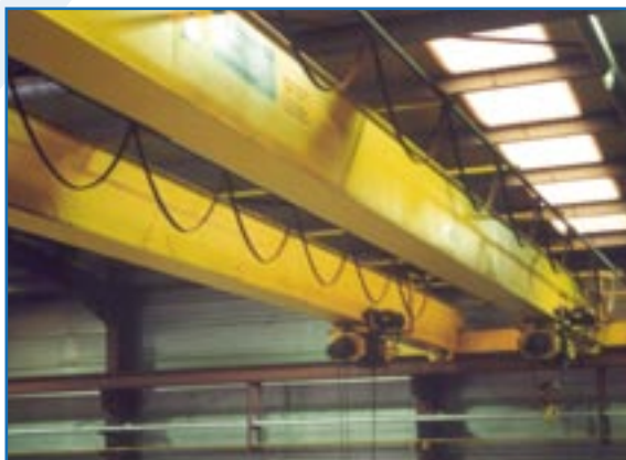
Pont roulant de capacité maximum de 10 t.
